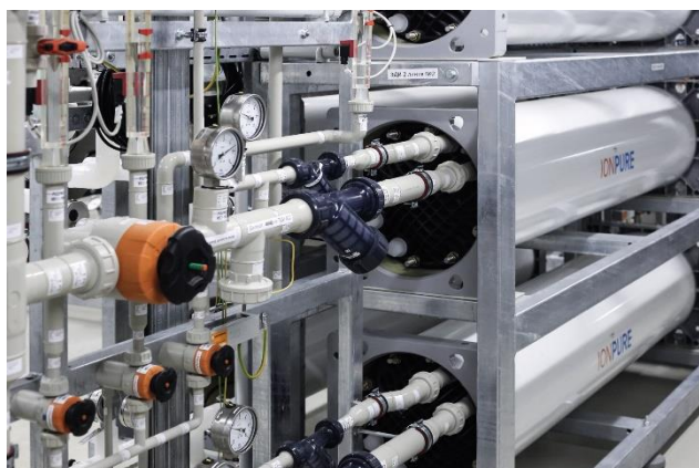
Bild 1: Die Erzeugung des Reinstwassers erfolgt durch eine Kombination aus Umkehrosmose und Elektrodeionisation.
