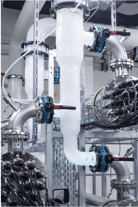
Bild 3: Die Reinstwasser-UV-Anlage zur TOC-Reduktion und Entkeimung.
