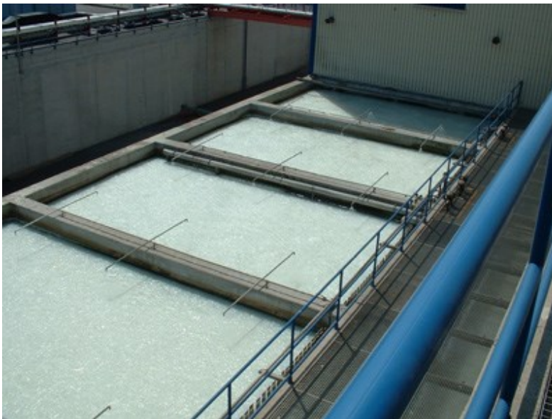
Bild 3: Biofiltration BIOFIT F zur weitergehenden Abwasserreinigung in einem großen Projekt der Papierindustrie, in dem Hager + Elsässer ihr neues AOP-Verfahren umgesetzt haben.
