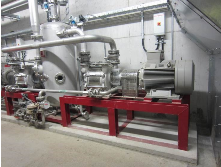
Bild 2: Sauerstoffweiterverwendung in einem großen Projekt der Papierindustrie, in dem Hager + Elsässer ihr neues AOP-Verfahren umgesetzt haben.
